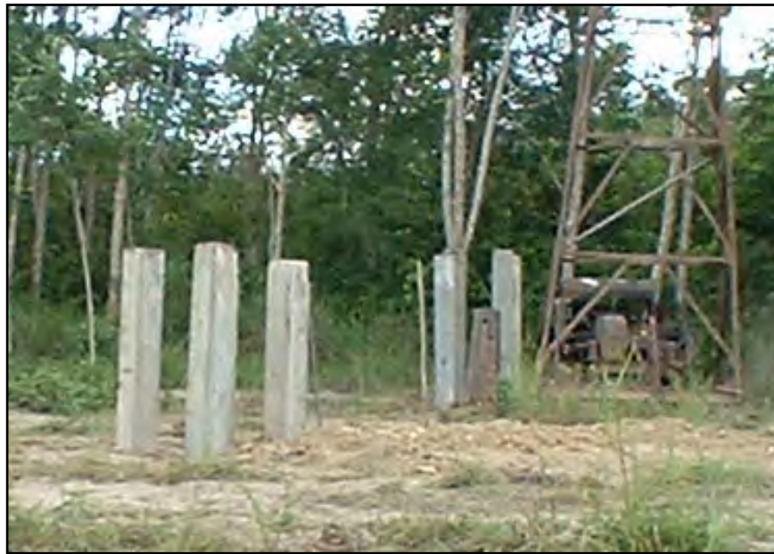
รูปที่ 1.6 เสาเข็มโผล่สูงเหนือดินเมื่อกำหนดความยาวเสาเข็มไม่ถูกต้อง
