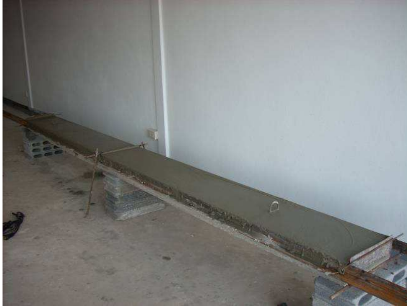
รูปที่ 13 การเทคอนกรีตทับหน้าหนา 5 ซม. รวมเป็น 10 ซม
