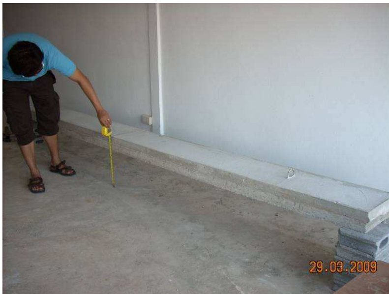
รูปที่ 14 วัดค่าการแอ่นตัวของแผ่นพื้นสำเร็จรูป “ก่อนรับน้ำหนัก”
