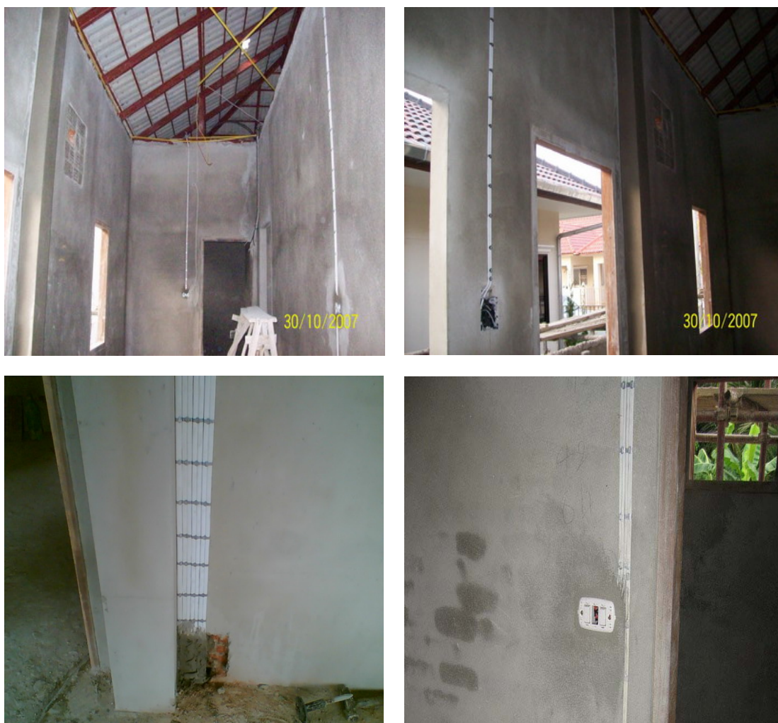
รูปที่ 3.1 การเดินสายไฟฟ้าในอาคารแบบเปิด(เดินลอย)
