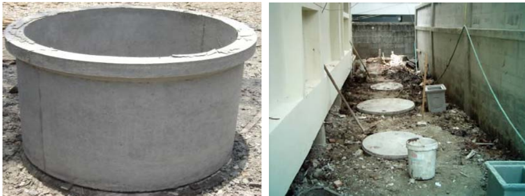
รูปที่ 3.39 บ่อเกรอะ บ่อซึม
