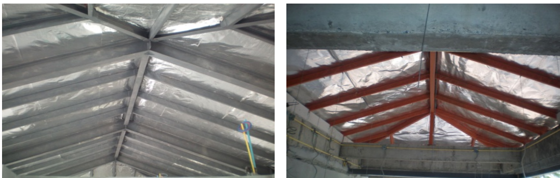
รูปที่ 1.134 งานที่ใช้วัสดุฉนวนกันความร้อนแบบอะลูมิเนียมฟอยล์
