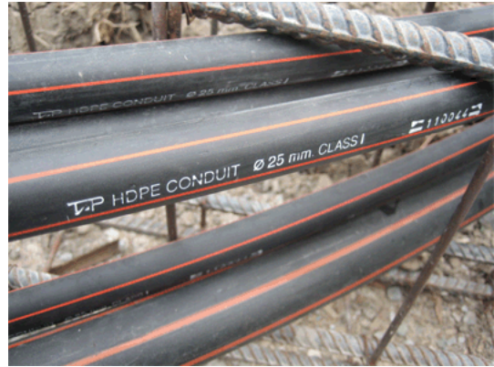
ท่อ HDPE ใช้ร้อยสายไฟใต้ดิน
