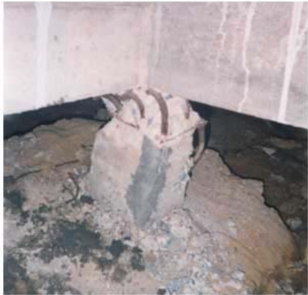
- รูปที่ 6 เสาเยื้องศูนย์บิดจนเสาแตก -
