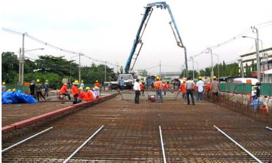
รูปที่ ค.6 การลำเลียงคอนกรีตโดยใช้คอนกรีตปั๊ม
