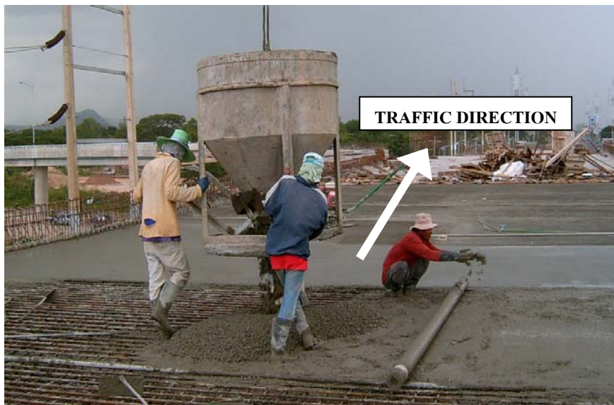
รูปที่ ข.1 แสดงตำแหน่งการวางตัววัดและทิศทางการรีด พร้อมทั้งเหล็กกระดပ်ในการเทพื้นคอนกรีตสะพาน
