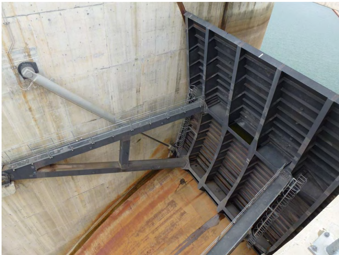
รูปที่ 24 : บานประตูระบายน้ำแบบบานโค้ง Radial Gates (15.0x16.0 ม.)
