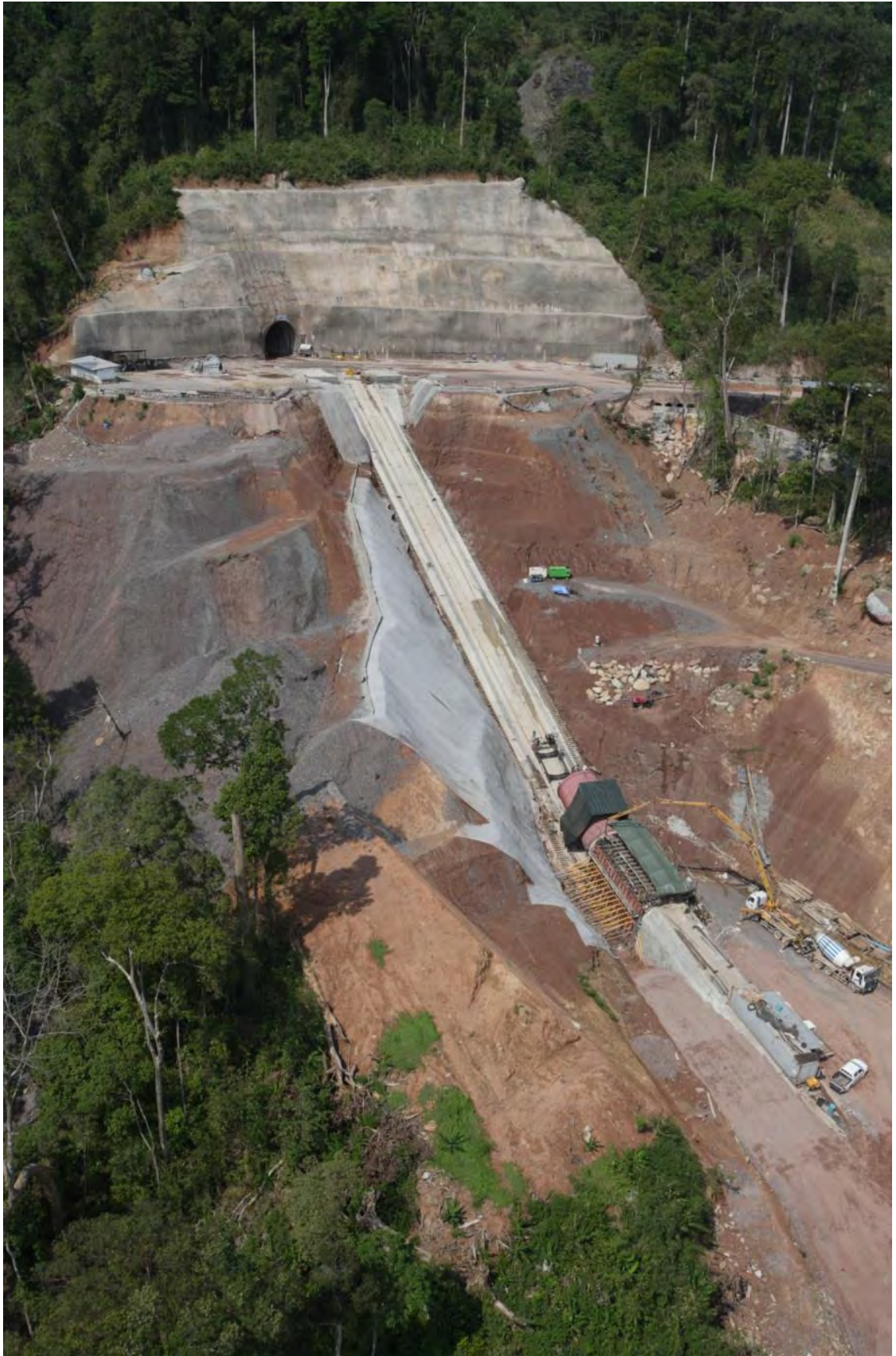
รูปถ่ายที่ 32 : ท่อส่งน้ำ (Penstock) เป็นแบบท่อเหล็ก Ø5.50 ม. หุ้มด้วยคอนกรีตฝังดิน ต่อจากอุโมงค์เข้าโรงไฟฟ้าใหม่
