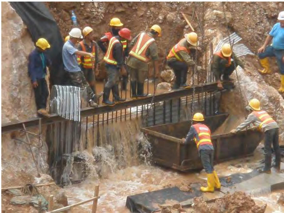
รูปที่ 45 : บริเวณจุดน้ำรั่วที่ใหญ่ที่สุด
