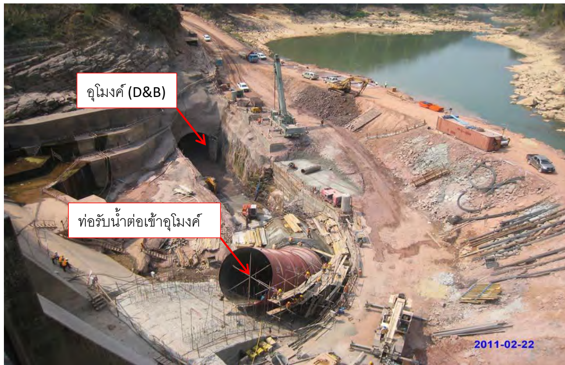
รูปถ่ายที่ 26 : ท่อเหล็กรับน้ำต่อเข้ากับอุโมงค์ส่งน้ำเข้าโรงไฟฟ้าใหม่
