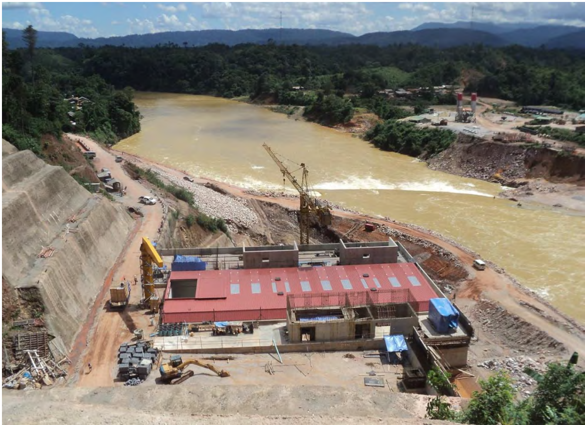
รูปถ่ายที่ 20 : อาคารโรงไฟฟ้าเขื่อนน้ำยวงอยู่ท้ายเขื่อน
