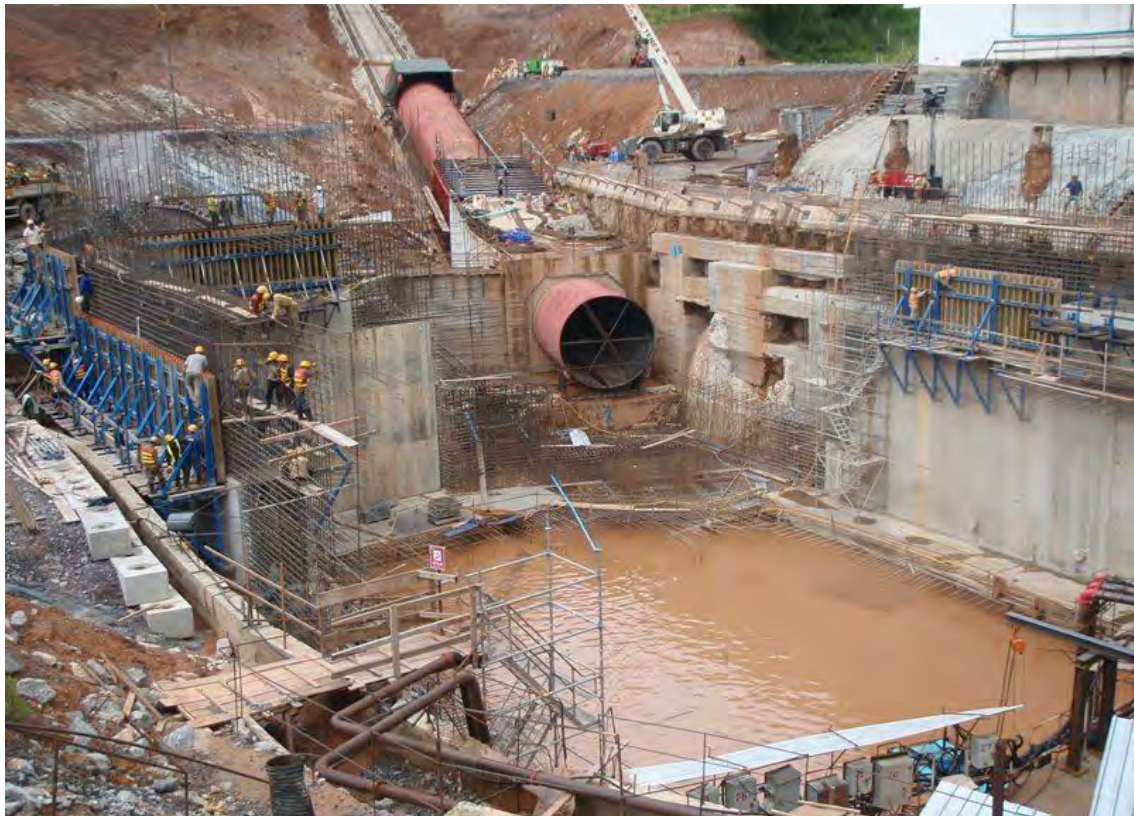
รูปที่ 46 : สภาพปอก่อสร้างที่ถูกน้ำท่วม
