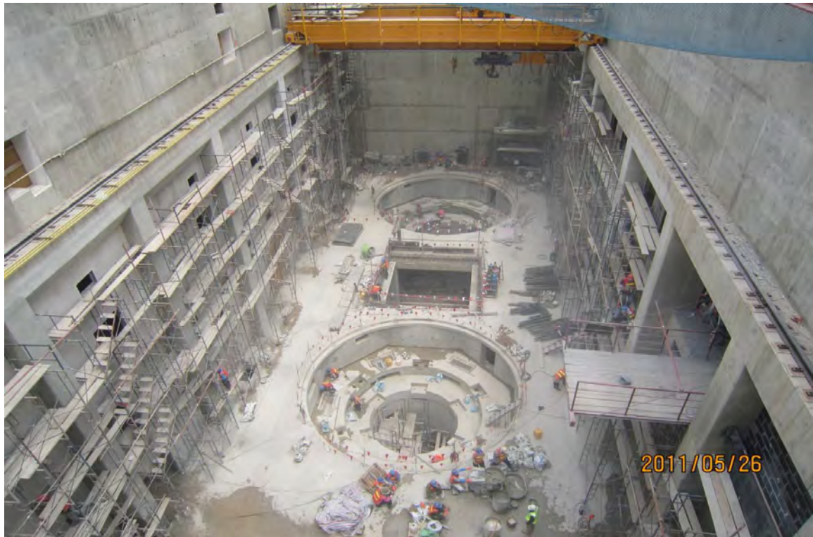
รูปถ่ายที่ 22 : ภายในอาคารโรงไฟฟ้าเขื่อนน้ำยวง Unit 1 และ 2 ( 2 \times 30 = 60 MW)
