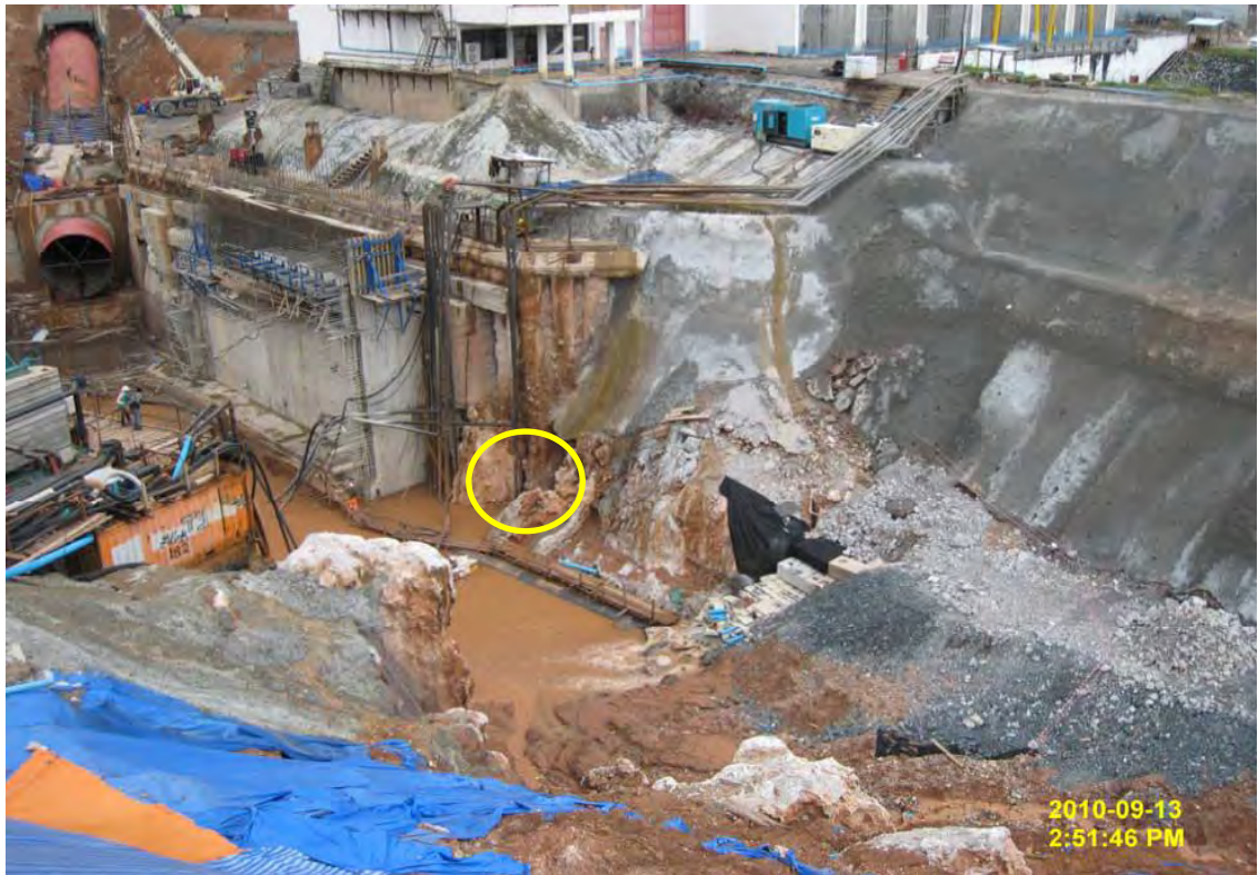
รูปที่ 44 : เมื่อขุดลึกลงไปประมาณ 25 ม.เกิดเหตุการณ์น้ำรั่วเข้าบ่อก่อสร้าง ซึ่งไหลซึมผ่านรูโพรงจากคลองระบายน้ำท้ายน้ำ (Tailrace Canal) เดิม เจลลี่ประมาณ 1 ลบ.ม/วินาที
