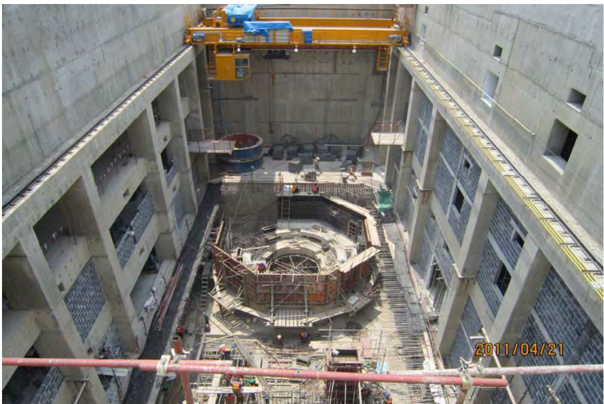
รูปถ่ายที่ 21 : ภายในอาคารโรงไฟฟ้าเขื่อนน้ำยวง Unit 1 (30 MW)
