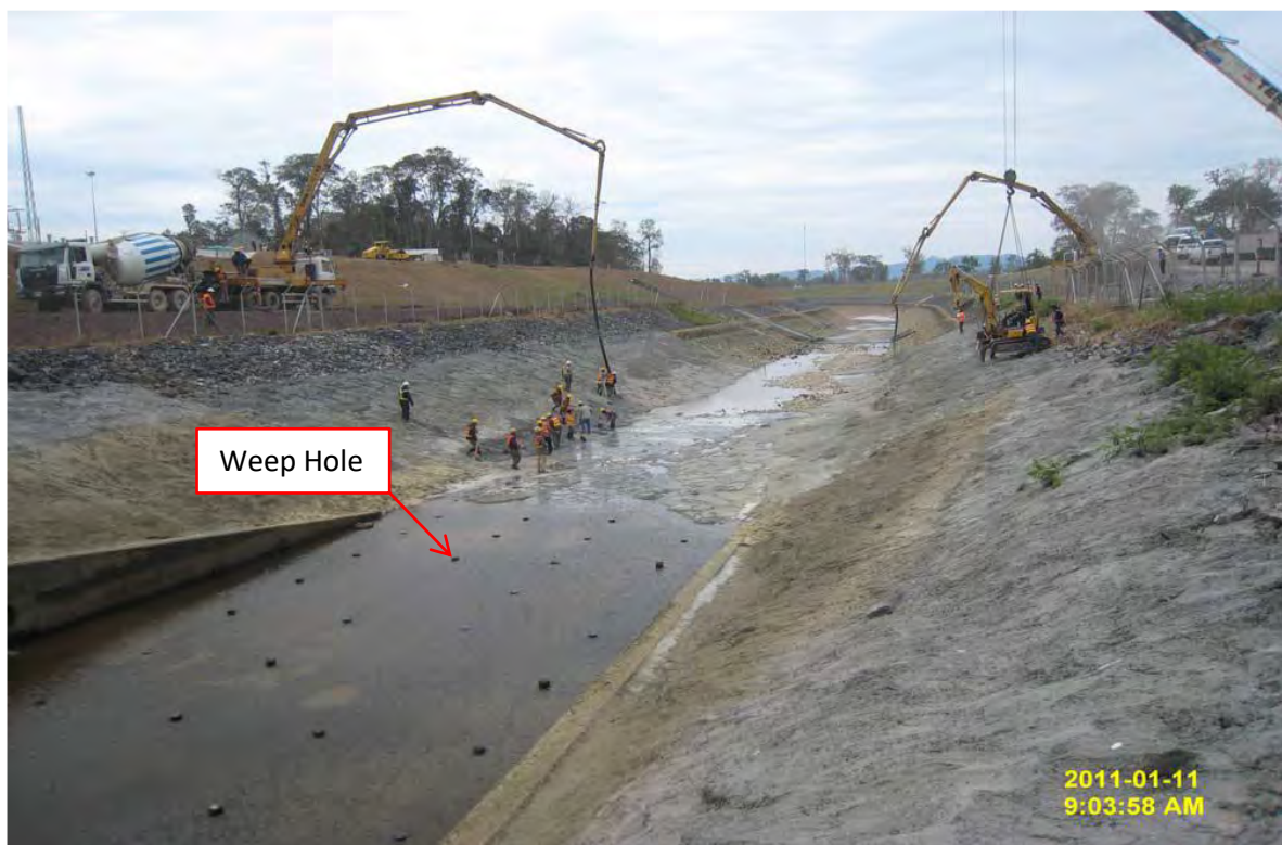
รูปที่ 47 : ขณะอุดรู Weep holes ที่คลองระบายเต็มแล้วและเทคอนกรีตคลุมส่วน Riprap ที่อยู่บน slope ปรากฏว่าหยุดน้ำรั่วได้
