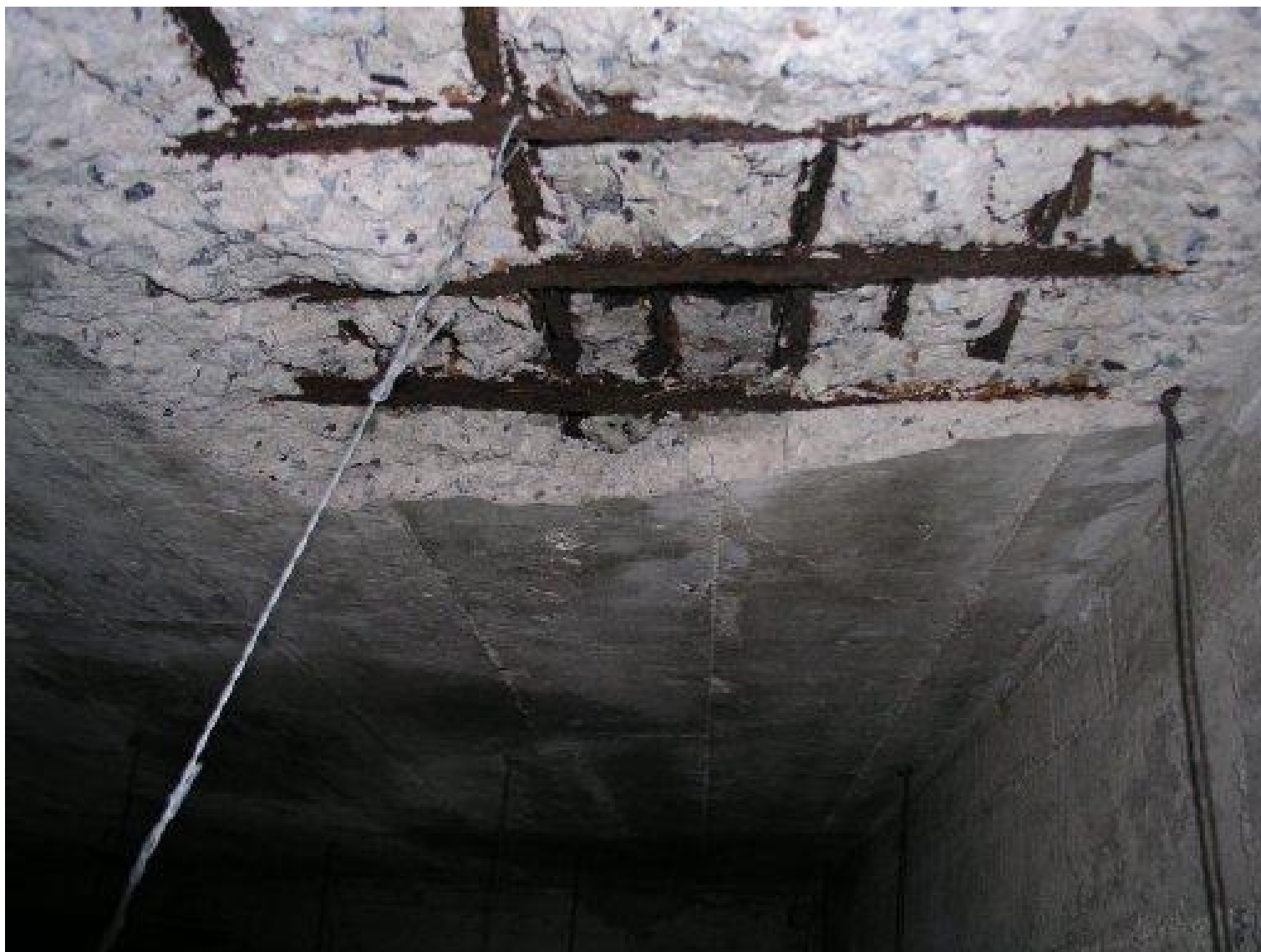
สภาพเหล็กเสริมพื้นห้องเครื่องที่เป็นสนิมขุม ดันให้คอนกรีตร่วงหล่น
