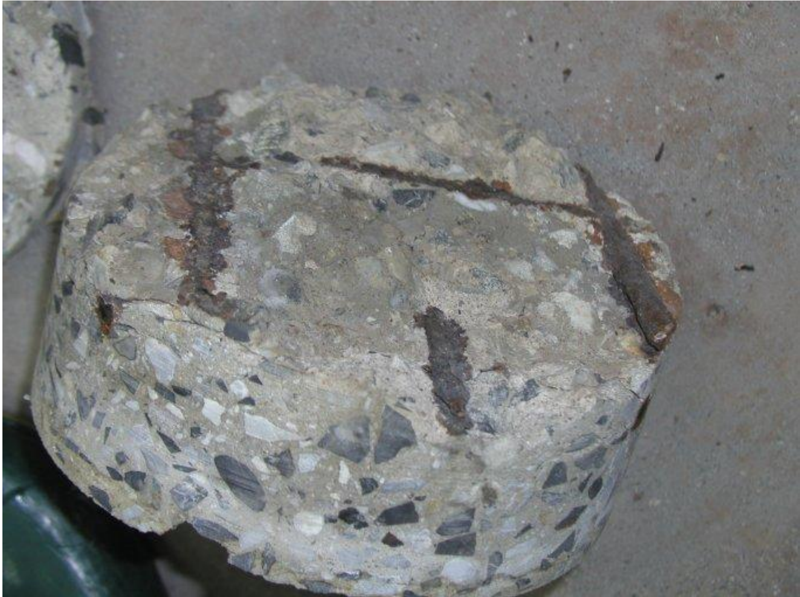
แท่งตัวอย่างที่ได้จากการ Coring พบว่าเหล็กเสริมเป็นสนิมจนเหลือเนื้อเหล็กน้อยมาก
