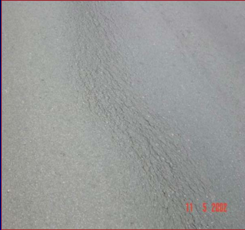
รอยแตก (Cracks)
