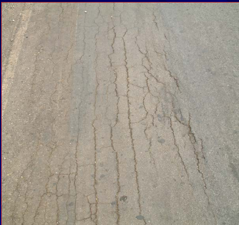
รอยแตก (Cracks)
