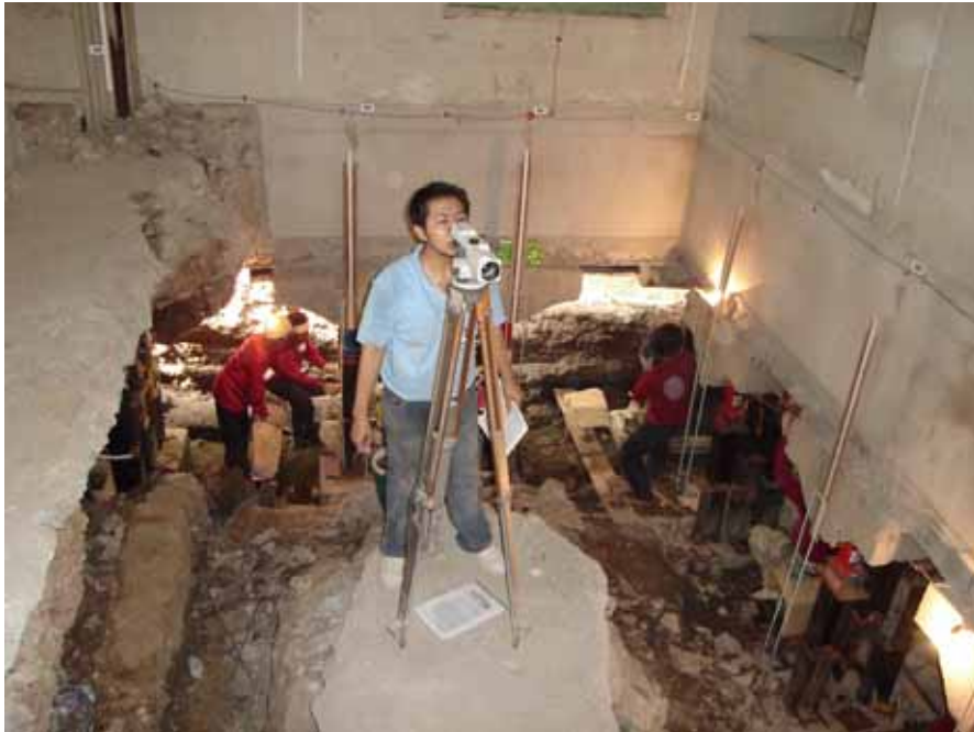
ตรวจวัดขณะยกอาคารตลอดเวลา ในภาพจะเห็นระดับพื้นอาคารลอยสูงกว่าระดับพื้นเดิมที่ยืนตรวจวัดค่าระดับ
