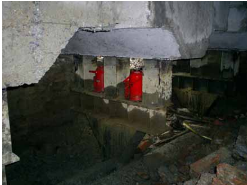
รูปแสดงการค้ำยันและจัดวางแม่แรงในสภาพพร้อมยกอาคาร
