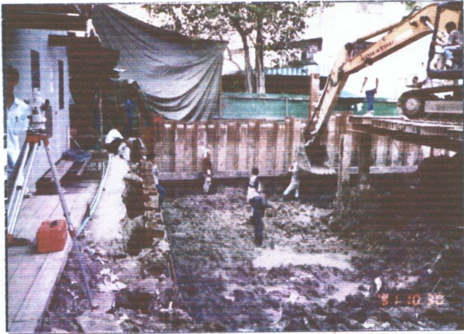
รูปที่ 14 ขุดดินชั้นแรก ระดับ - 1.40 เมตร
