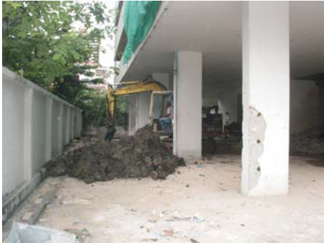
รูปที่1 สภาพอาคารเก่าบริเวณพื้นชั้นล่าง
