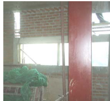
รูปที่14 แต่งรอยเชื่อม ทาสีแผ่นเหล็กตามมาตรฐาน
